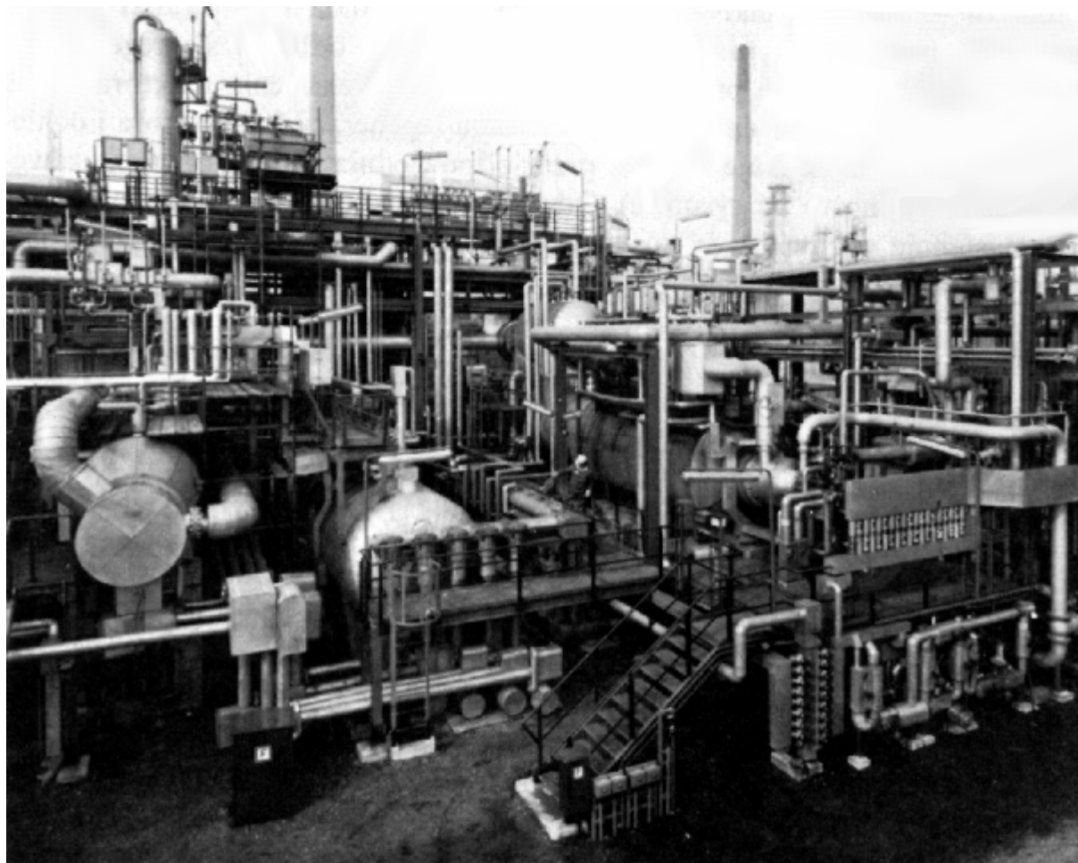
Fot. 2. Fragment instalacji Claus-Sulfreen [2]
